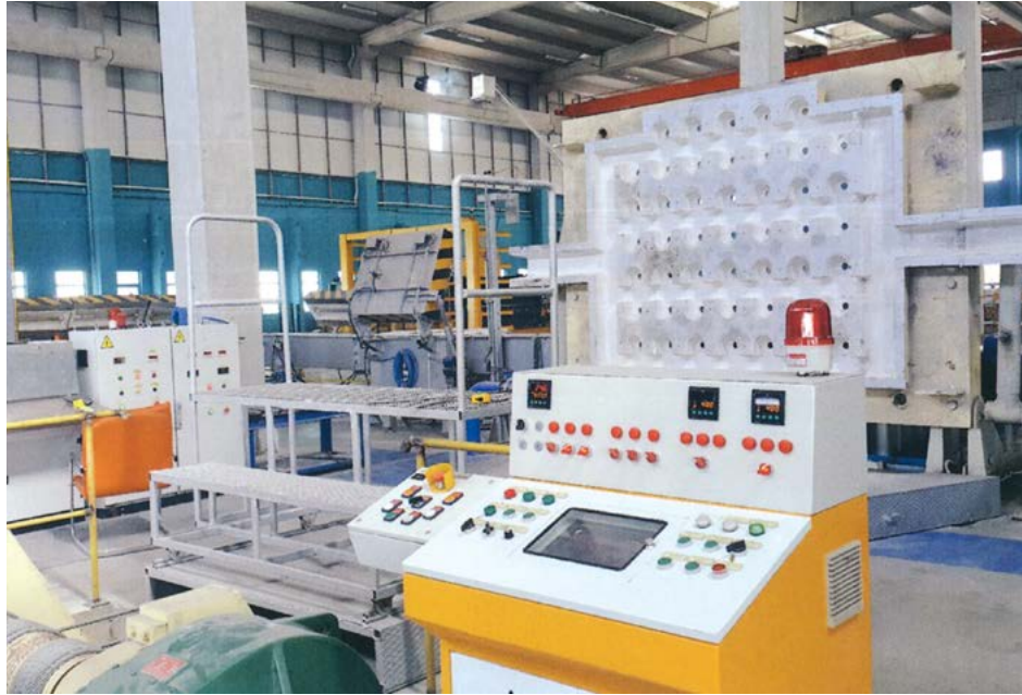
PLC and Touch Screen Controlled Casting Units Döküm Kontrol Sistemleri ve Otomasyonu
